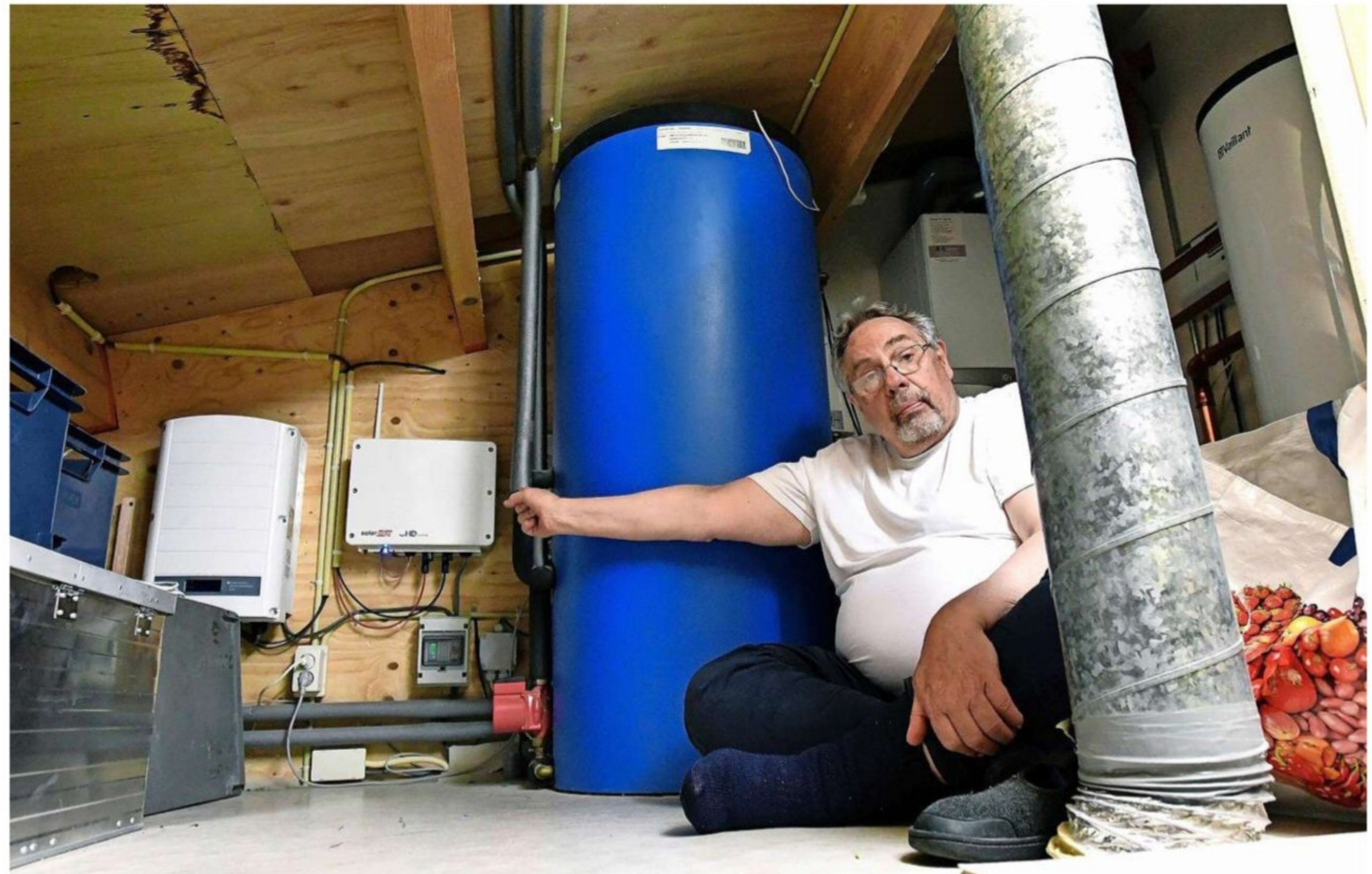
De omvormers van Jan Kaauw slaan regelmatig af als de spanning op het elektriciteitsnet te groot wordt.
